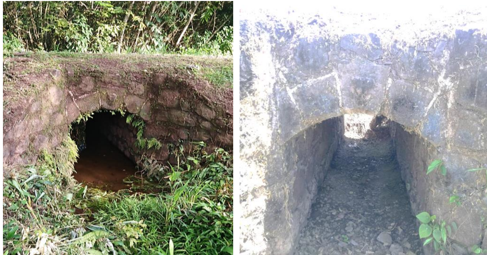
Figura 21. Puente de piedra del antiguo camino de Montijo a Minerales, también conocido como Camino de La Mina. Fuente: Fotografía Sebastián Aguilar.
