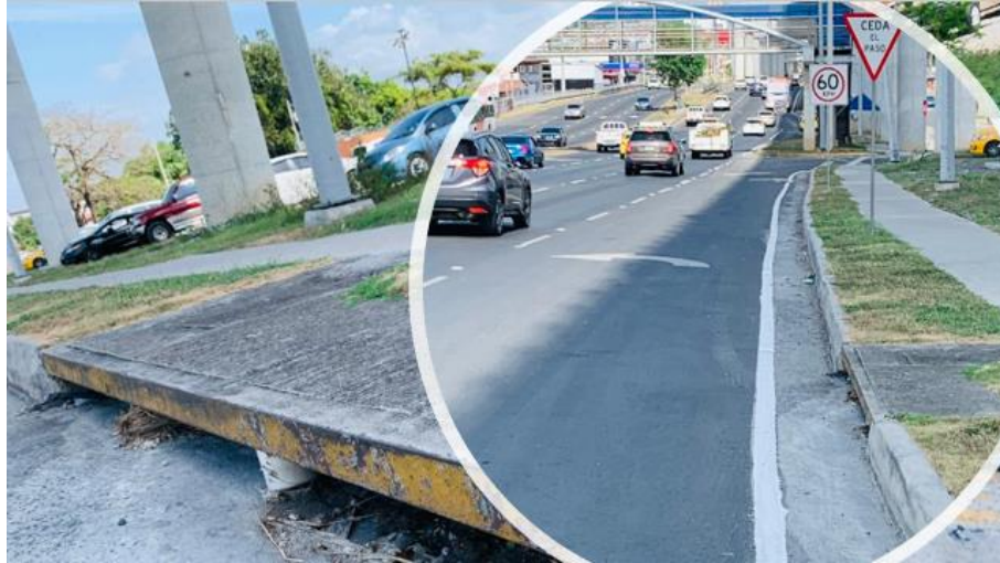
Ilustración 8. Altura de estructura de drenaje construido en 2016 sobre la Domingo Diaz.
